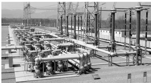
图1 某GIS变电站图
